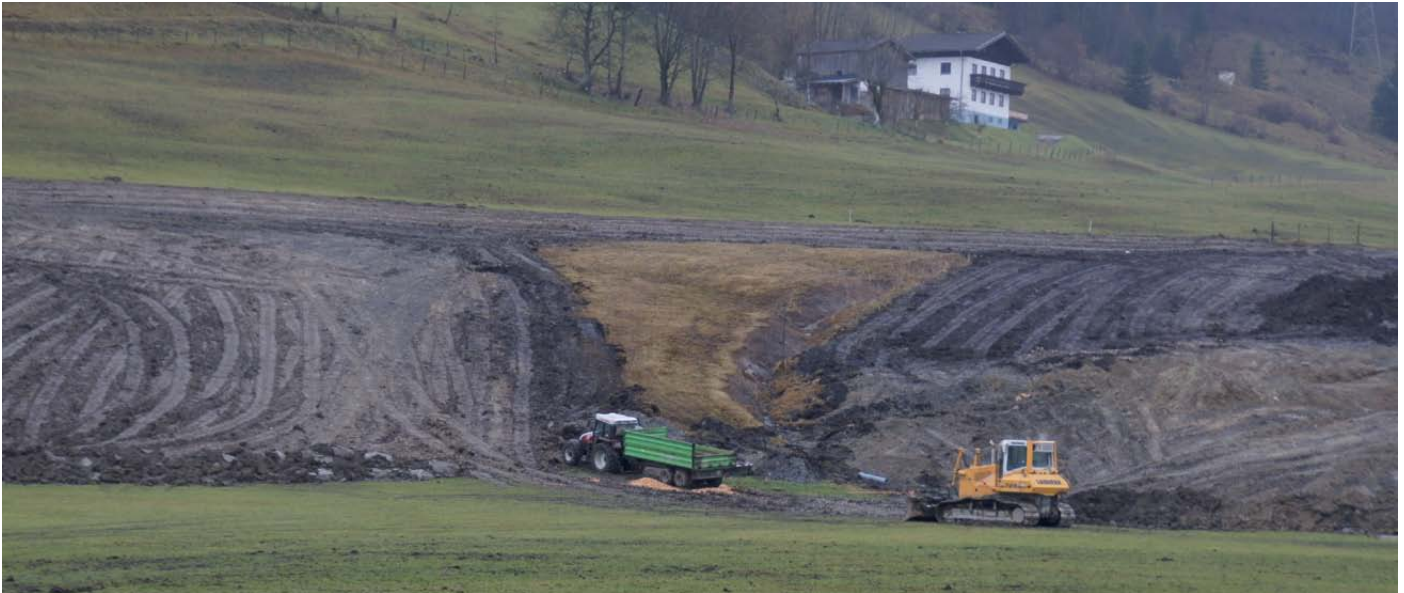
Die Moorzerstörung ist von der Pinzgauer Bundesstraße aus deutlich sichtbar.
