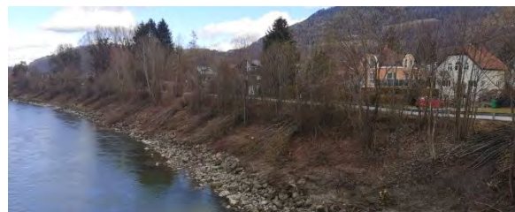
Abb. 2: Der Hochwasserschutz erfordert bis ins Stadtgebiet hinein ökologisch bedenkliche Rodungsarbeiten an den Salzachuferrn. Foto: LUA (lb)
