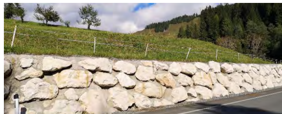
Abb. 4: In diesem Bereich hätte aus ökologischer Sicht eine Erdböschung errichtet werden müssen. Alternativ hätte eine Trockensteinmauer zu ökologisch verträglicheren Konditionen errichtet werden können. Foto: Lukas Bofinger
