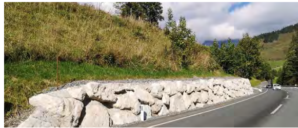
Abb. 3: Eine mit Gehölzen begrünzte Böschung würde eine langlebigere Standsicherheit gewährleisten als ein betonverfugter Steinsatz. Schwerkraft und Bodendruck führen langfristig zu Rissen und möglicherweise größeren Schäden an der Mauer. Schon in wenigen Jahrzehnten sind Instandhaltungskosten zu erwarten. Eine ökologische und finanzielle Fehlplanung. Foto: Lukas Bofinger
