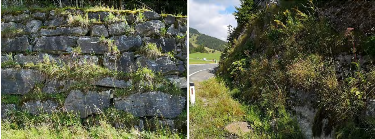
Abb. 5: Begrünte Trockenmauern können als Schwergewichtsmauern mit gleichwertigen Eigenschaften errichtet werden, mit ökologisch deutlichen Vorteilen. Foto: Lukas Bofinger
