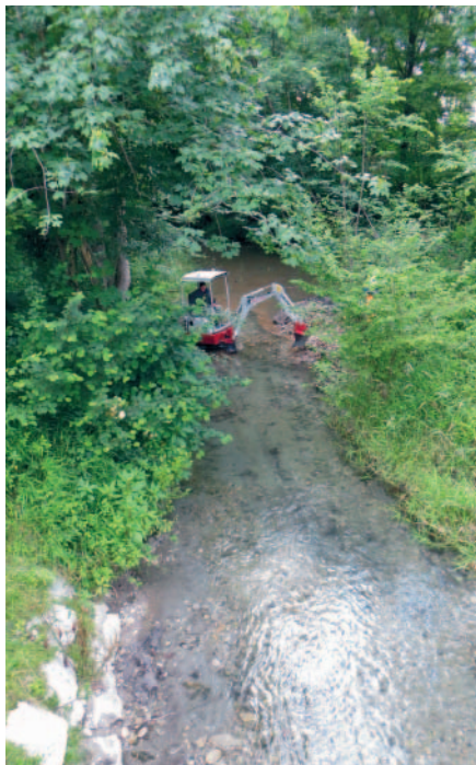
Unbewilligte Baggerungen im geschützten Alterbach ohne ökologische Bauaufsicht. Foto: LUA
